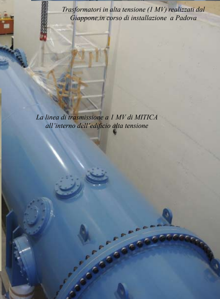
Installazione della linea di trasmissione a 1 MV di MITICA
