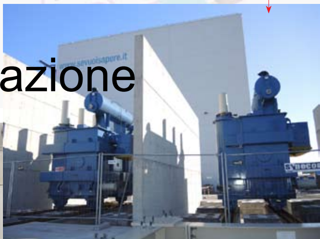
Trasformatori in alta tensione (1 MV) realizzati dal Giappone, in corso di installazione a Padova
