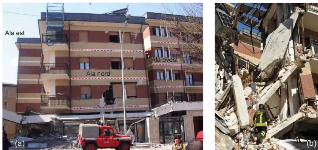
Figura 6-6 – Casa dello Studente prima della demolizione dell'ala crollata: a) meccanismo di piano debole nell'ala nord; b) Collasso delle colonne all'interfaccia tra l'Ala Nord (destra) e le rimanenti (sinistra e posteriore). (riadattata da Mulas e Martinelli, 2017)
