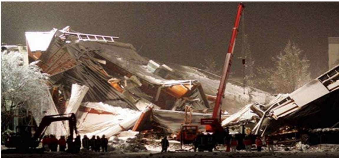
Figura 6-43 – Collasso della copertura della Bad Reichenhall ice-arena nel 2006 in Germania (da https://www.cbsnews.com/pictures/germany-roof-collapse/18/ )
