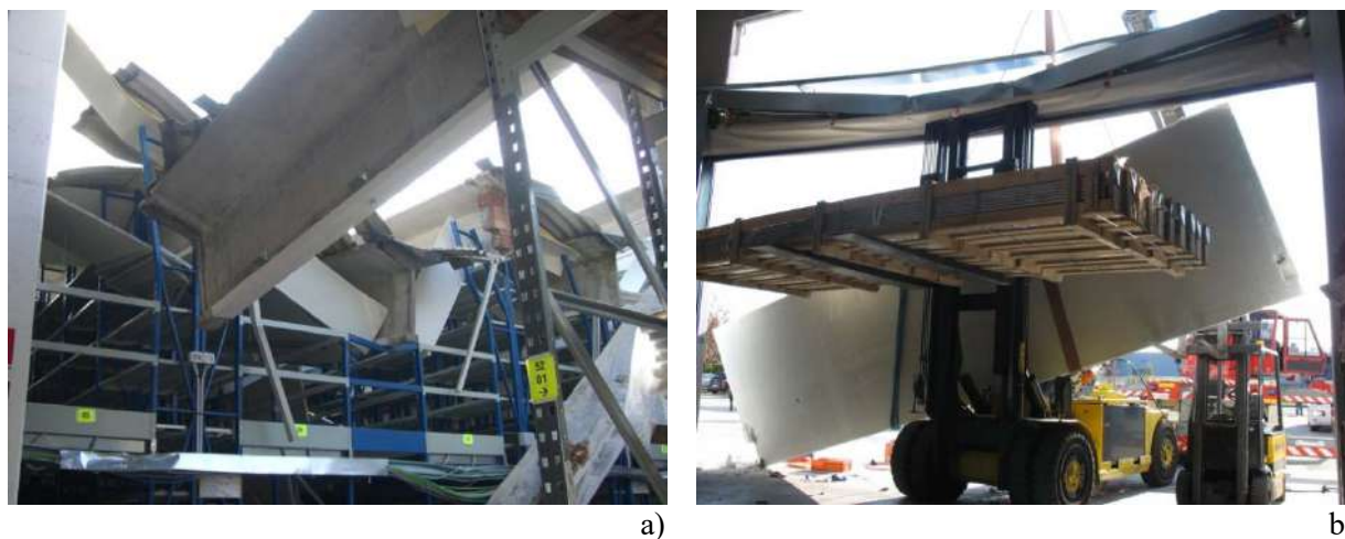
Figura 6-21 – Crolli per azioni eccezionali (non sismiche): a) collasso per azione della neve che ha causato compressioni non sopportabili dall'appoggio di una trave su un pilastro; b) caduta di un pannello di tamponamento urtato dalle forche di un carrello elevatore
