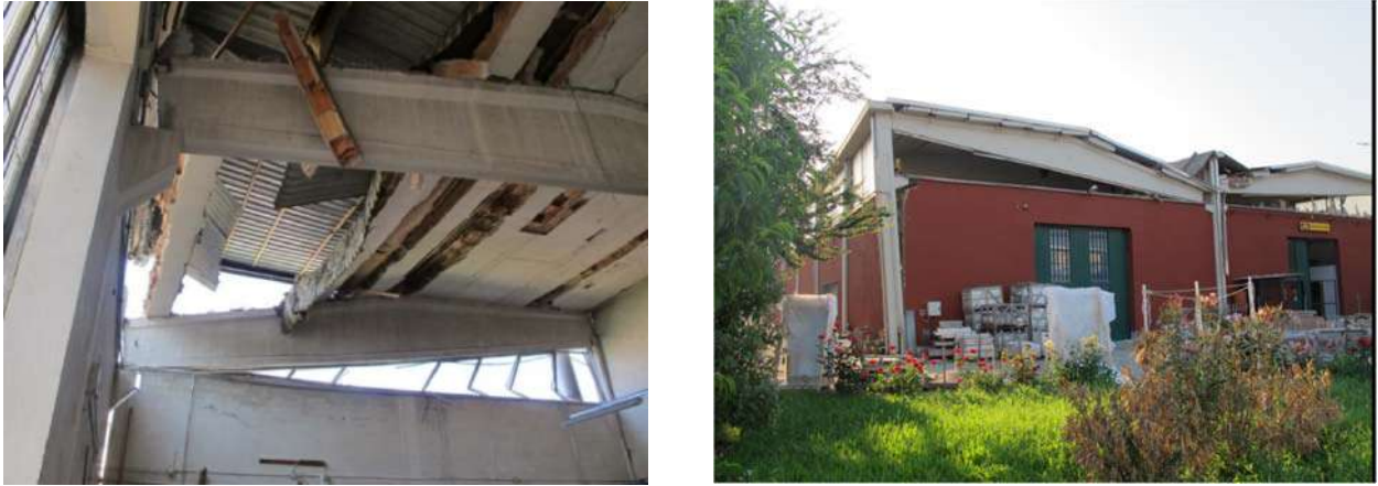
Figura 6-16 – Crolli per perdita di appoggio delle travi su pilastri.
